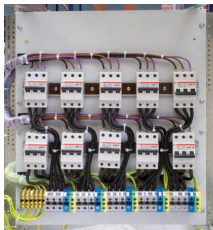
Входная панель AC с выключателями / AC input panel with breakers
